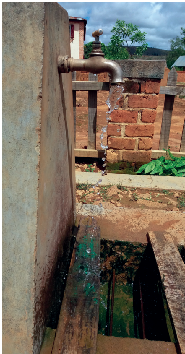
Distribution d'eau potable en région Analamanga
